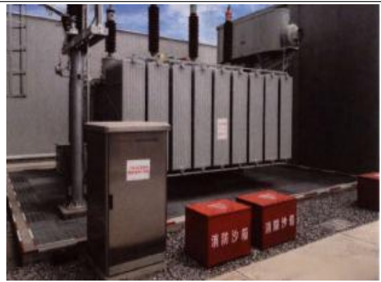
1号主变下方事故油坑
